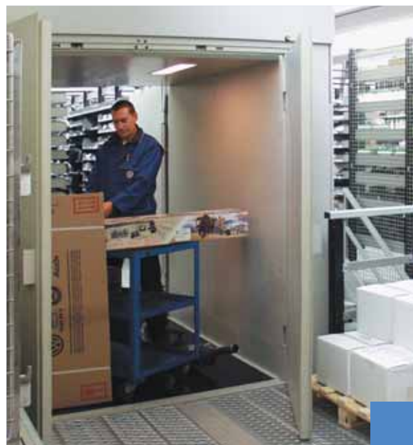
Installazione in un concessionario di automobili (Italia), modello 1000 kg, doppio accesso con porta a due battenti.
